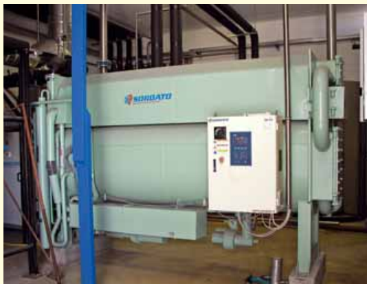
Foto 3 Assorbitore monostadio. È una macchina che utilizza come fluido di lavoro una soluzione di bromuro di litio e acqua. L'acqua opera da refrigerante e il bromuro di litio, un sale stabile con alta affinità per il vapore d'acqua, da assorbente. Sfruttando l'acqua calda prodotta dalla caldaia, produce acqua a 7° C per il raffreddamento della cantina
