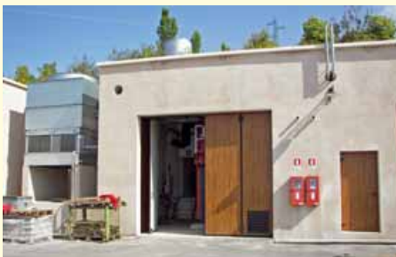
Foto 1 Centrale termofrigoriferica e torre evaporativa. All'interno si trova la caldaia a biomasse di 400 kWt e l'assorbitore di 280 kWf
